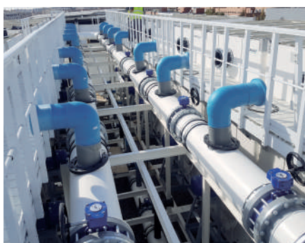
Sistemas de condensación.
