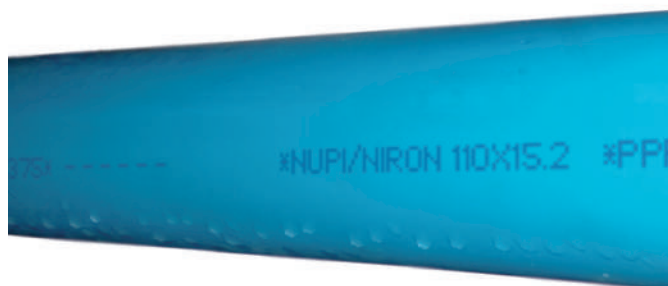
Estado de tubería NIRON con condensación superficial.
